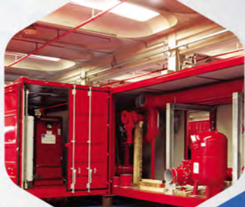
پکیج پمپ خانه آتش نشانی (Fire Fighting Pumps Containers)
