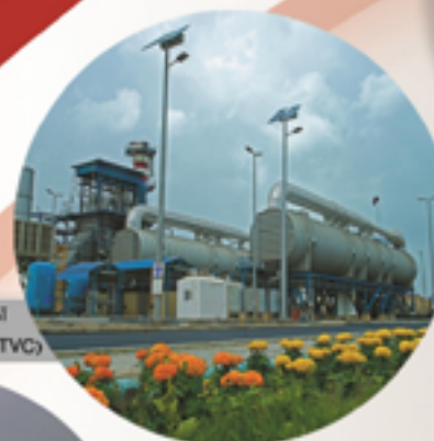
سیستم تامین خلاء حرارتی بخار (Steam Ejector)
