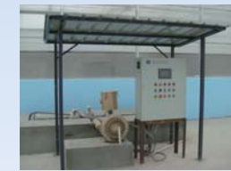
自动曝气系统 Aeration System
